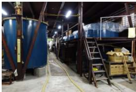
蔵のなかにはあちこちに筋違がある。建物の強度を優先した熊本県酒造研究所の工場
